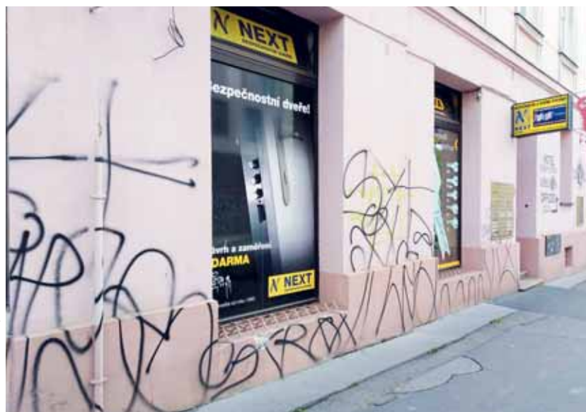
Fasáda domu napadená vandalem...
