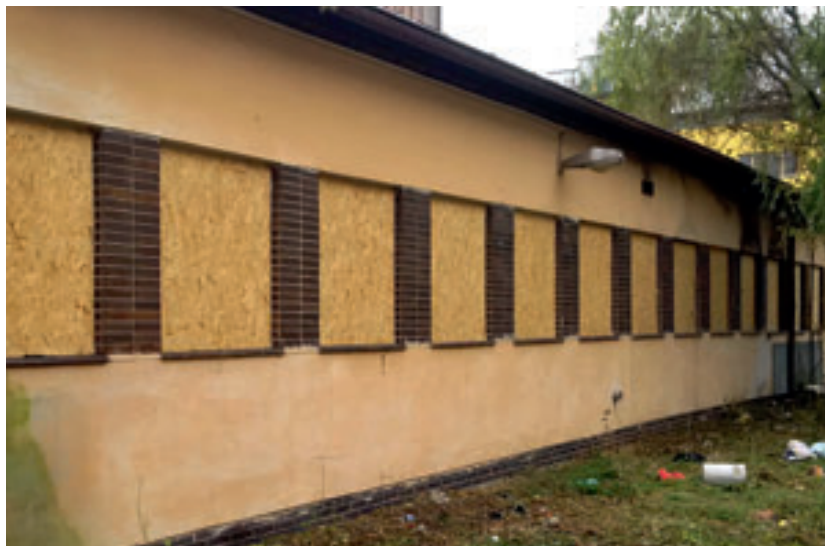
Snadno přístupná okna byla zabeďněna
