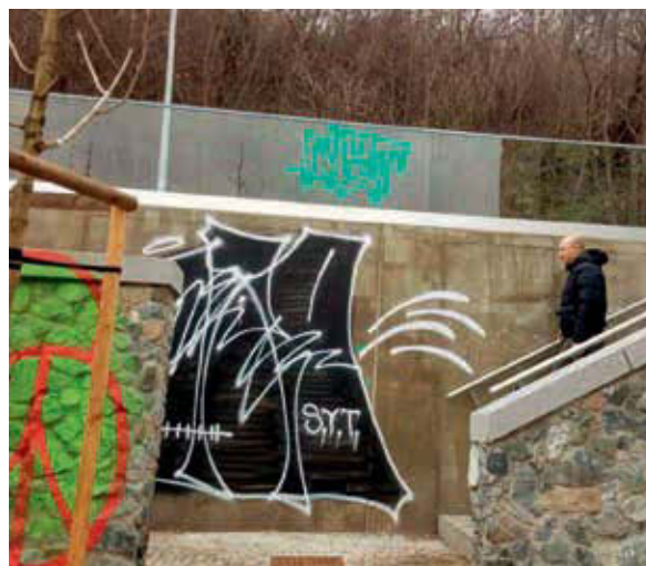
Nástup na cyklostezku pod Vítkovem, který radnice právě dokončila, poničili vandalové
