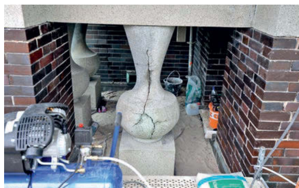
Balustráda na severní stěně na opravu teprve čeká
