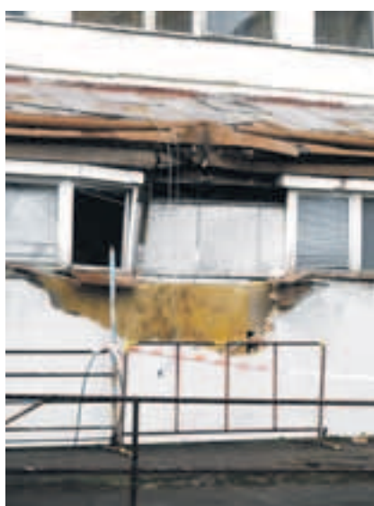
Čelní administrativní budovu poškodila nedávná nehoda vagónů při posunu.
