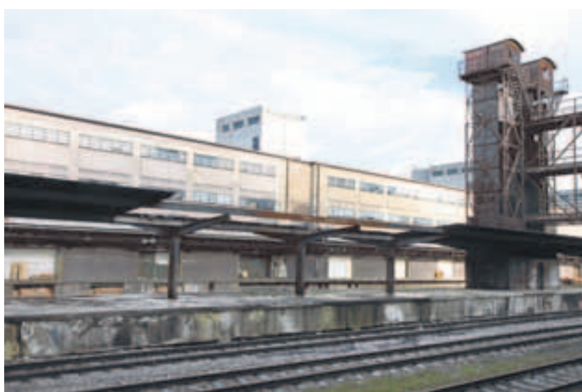
Chybějící střecha nad perónem je důsledkem požáru opuštěného vagónu, který využívali výrobci drog.
